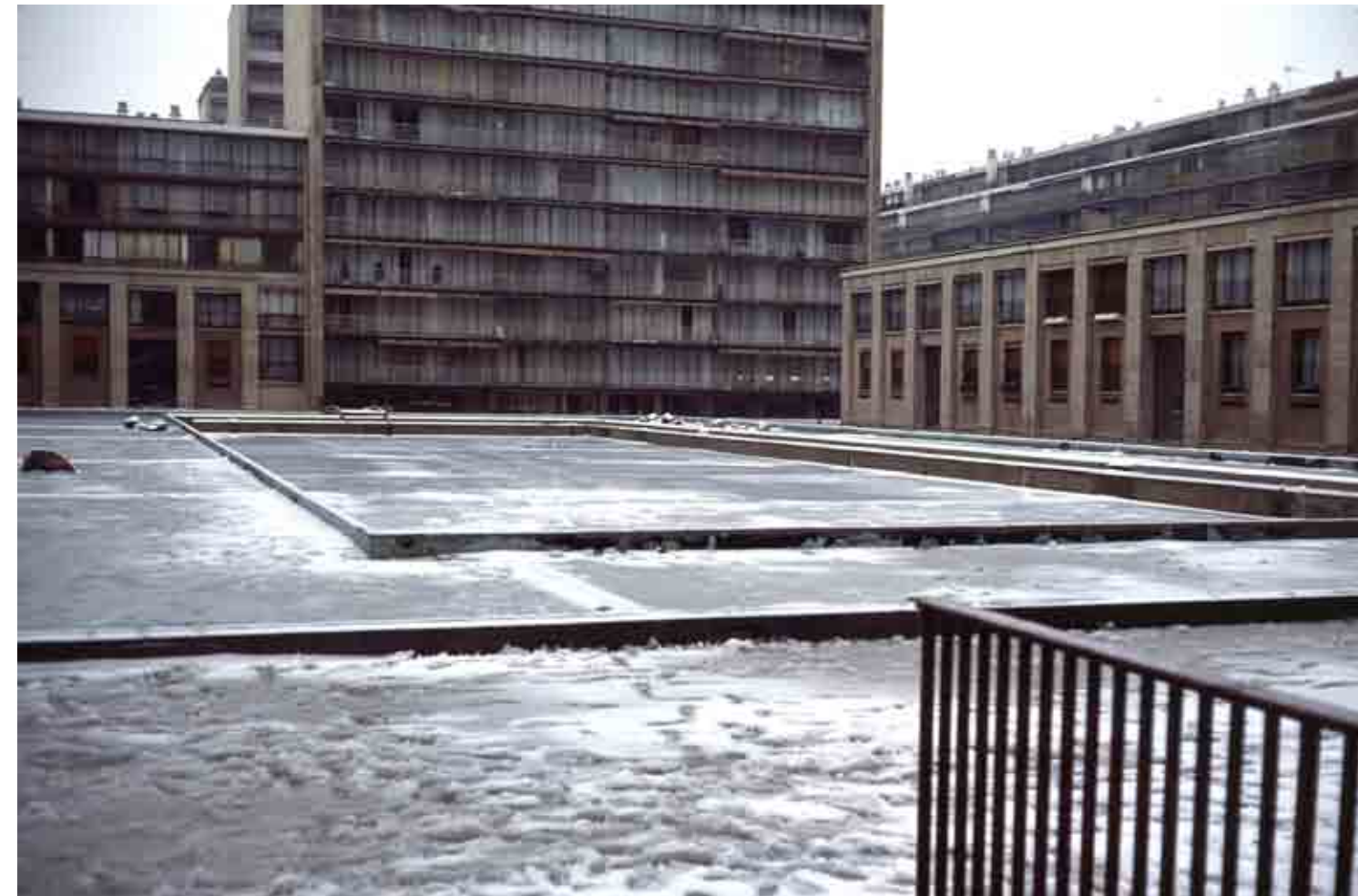
Hiver 1978: chantier de réfection de la place St-Germain des longs prés Prêt résident M. Verdier
